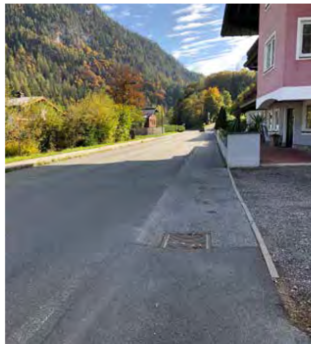
Ungesicherter Bereich für den Fußgänger auf der rechten Seite in Richtung Ortsende. Die Trennung zwischen PKW-Verkehr und Fußgänger fehlt.
